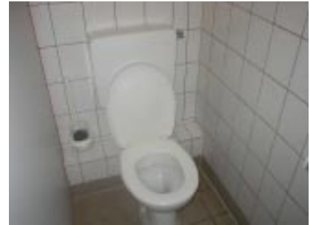
Abb. 10: Toilette mit Wassersparspülkasten
