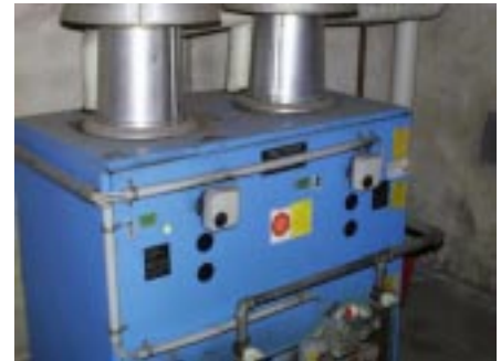
Abb. 3: Veralteter Heizkessel einer Turnhalle
